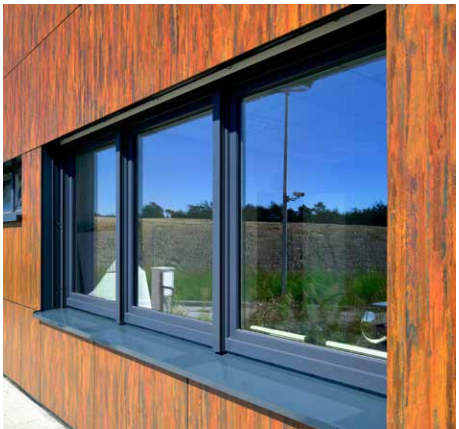
Die robuste, pflegeleichte Aussenhaut des Gebäudes passt sich wunderbar den waldlichen Standortgegebenheiten und der Arbeit des Unternehmens Nottenkämper mit mineralischen Stoffen an.
